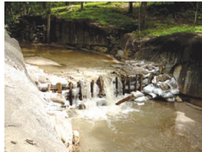
การทำฝายชะลอน้ำแบบต่างๆ เพื่อชะลอน้ำสร้างความชุ่มชื้นให้แก่ป่า และการบริหารจัดการน้ำในชุมชนแม่ระวาน จ.ตาก
